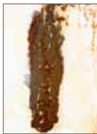
BEZ Allgrund: Brak ochrony antykorozyjnej
