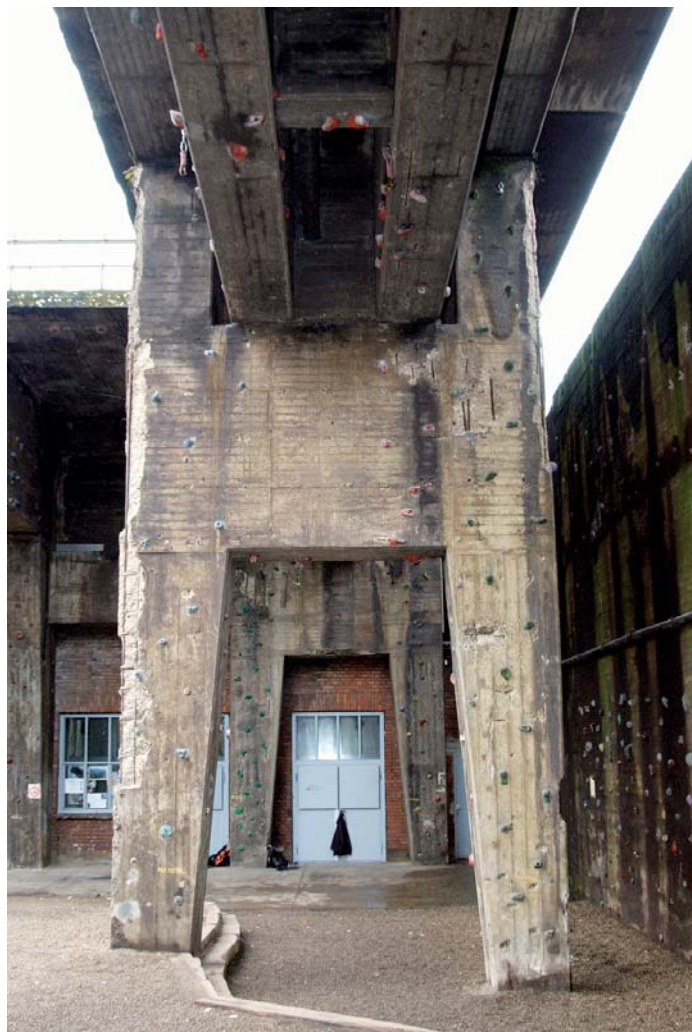
Untersuchung der Schadensbilder an den Stützen
