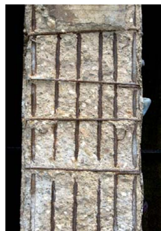
Pfeileroberfläche mit Sekundär-oberfläche; Originaloberfläche wurde durch Korrosionsdruck der Stähle flächig in Form einer Schale abgedrückt
