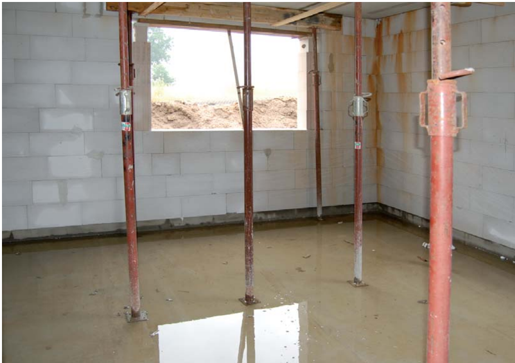
Die typische Situation auf der Baustelle: Ohne Hinterfeuchtungsschutz wäre hier schon ein Schaden vorprogrammiert.
