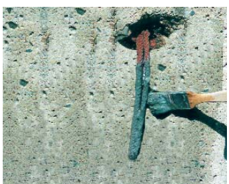
Streichen der entrosteten Bewehrungsstäbe mit einer Schlämme aus Betofix RM und Rostschutz M.
