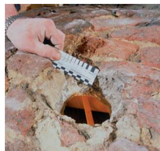
Durch die hohen Salzgehalte waren die Ziegel bereits auf wenige cm zurückgewittert.
