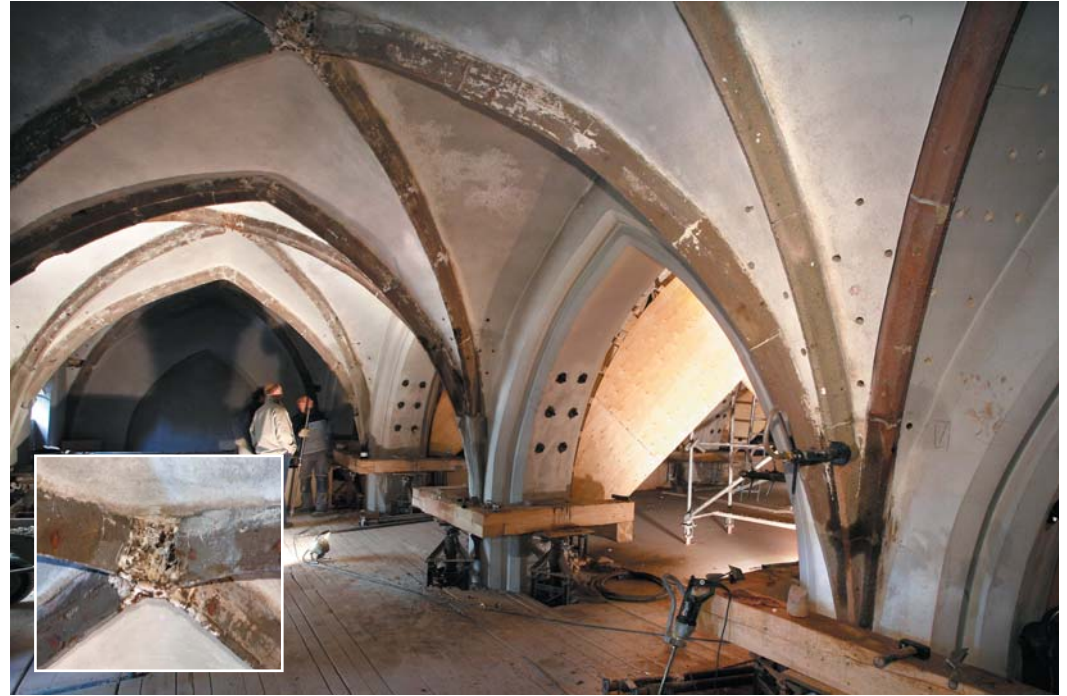
Blick in das Kirchengewölbe während der Instandsetzungsarbeiten. Die Ziegelgewölbe aus dem 16. Jahrhundert befanden sich in einem äußerst desolaten Zustand. Die Natursteinrippen wurden mit Remmers Kompressenputz entsalzt.
