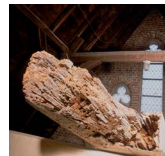
Schwammbefall im Dachstuhl, wichtige Aufgabe für Remmers Holzschutzprodukte.
