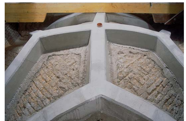
Oberhalb der Kreuzrippen wurden Überzüge aus einem speziellen Gewölbe-Tragmörtel aufgebracht. Die dazwischenliegenden Kalk/Bimsstein-Gewölbekappen wurden bereits mit CVS-Gewölbetränkstoff getränkt.
