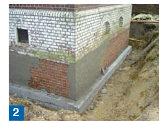
2 Grundvergieselung mit Kiesol (1:1 in Wasser), Fugen füllen, Untergrundegalierung und Dichtungskehle mit Remmers Dichtspachtel.
