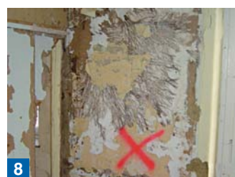
8 Zerstörter Wandputz mit Mycelien des Echten Hausschwammes.
