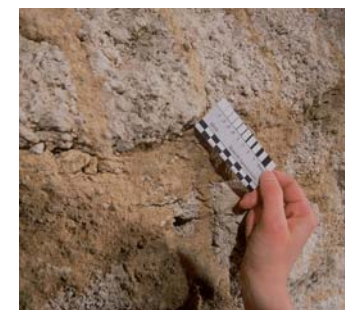
Extreme Rückwitterungen auch am Kalk-Bimsstein-Gewölbe.
