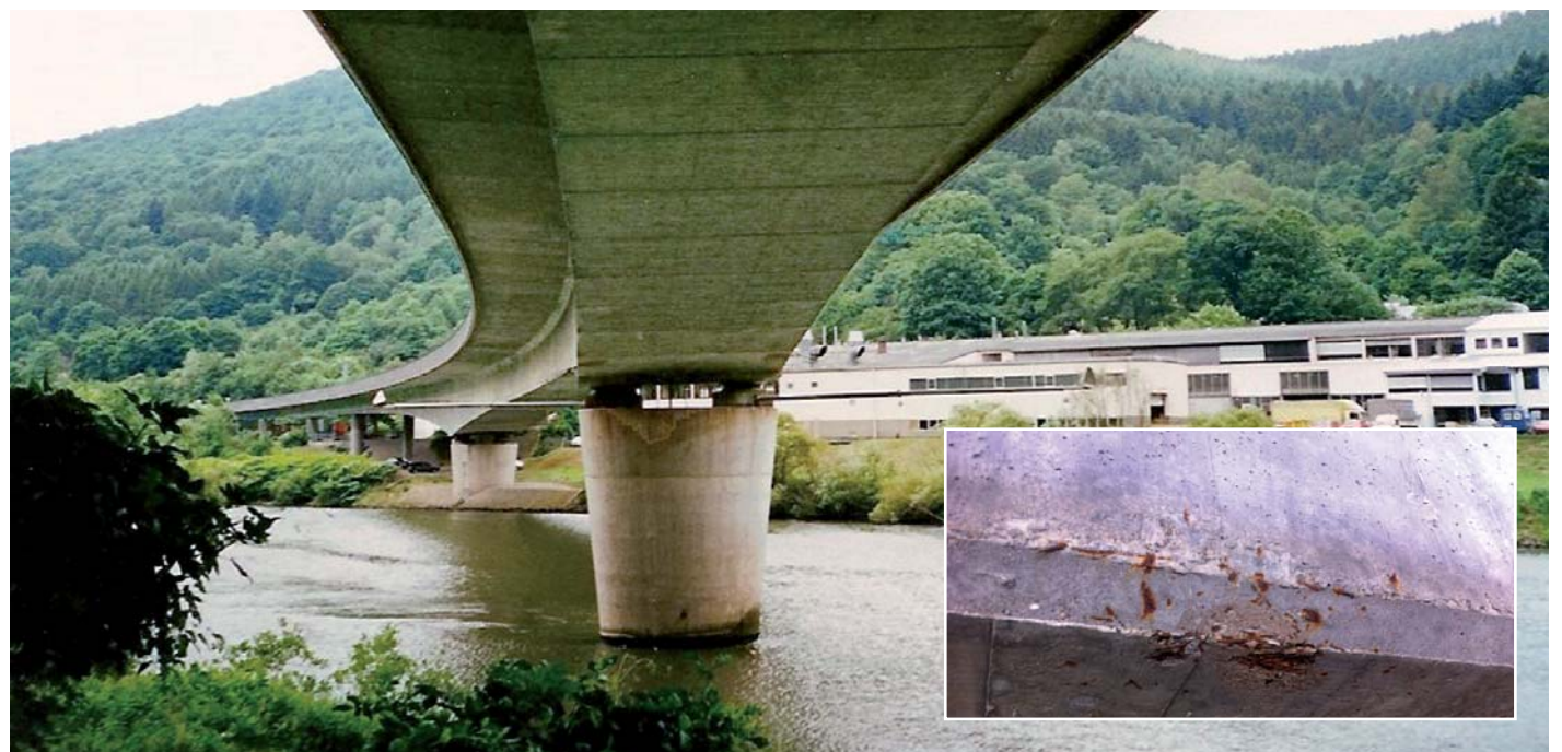
Ambitionierter Brückentwurf: Die geschwungene Unterkante des Kastenträgers und die elliptischen Pfeiler, die sich nach unten verjüngen, lassen einen hohen gestalterischen Anspruch erkennen. Das Bild zeigt den Vorzustand mit Betonschäden durch Carbonatisierung im Laufe von 30 Jahren, rostender Bewehrungsstahl.
