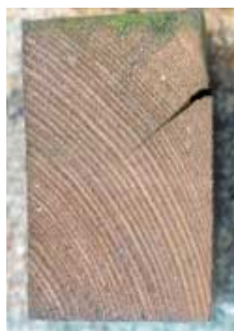
Ohne Hirnholzschutzmittel: es kommt zur Feuchteaufnahme, Volumenzunahme und Bläuebildung
