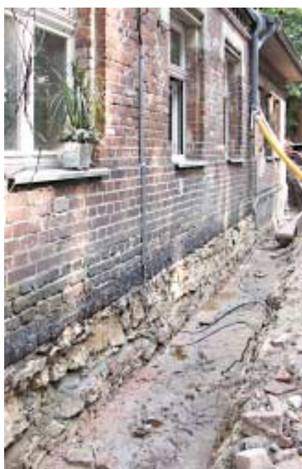
Grundwasser ab einer Tiefe von ca. 100 cm und fehlende Abdichtungen haben das Mauerwerk durchfeuchtet
