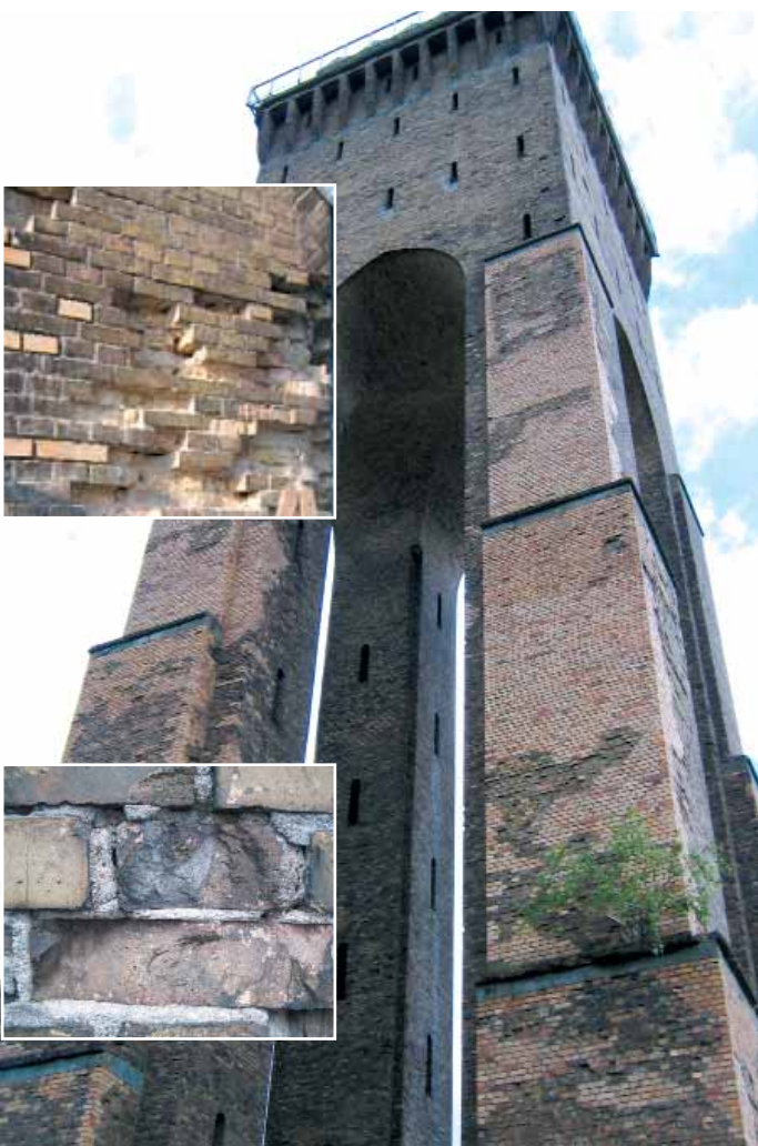
Zustand der Fassade vor der Instandsetzung: scherbeliger Zerfall der Klinker
