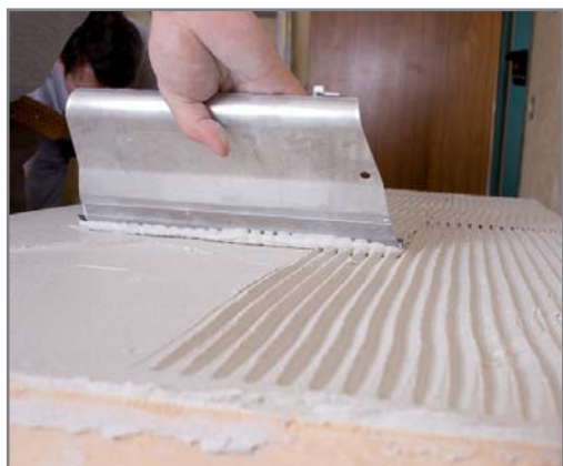
Der Kleber iQ-Fix wird auf ebenem Untergrund und auf die Platten mittels Zahnkelle mindestens 5 Millimeter dick aufgetragen. Batzen- oder Punkt/Wulst-Verklebungen sind nicht zulässig.
