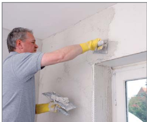
Die Fläche wird mit dem Flächenspachtel abgezogen. Der Auftrag der zweiten Lage Armierungs- und Oberputz erfolgt frisch-in-frisch.
