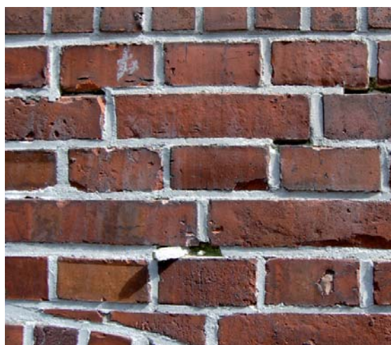
Sichtmauerwerkfassade mit defekter Verfugung
