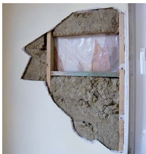
Durchfeuchtete Dämmung mit Dampfsperre
