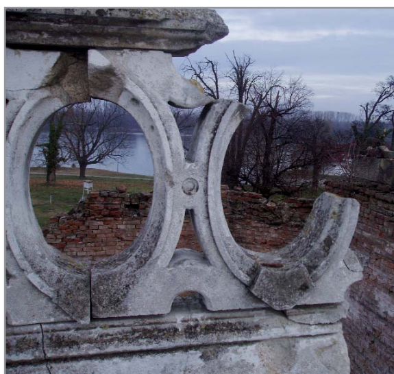
Vorzustand des Geländers aus Kalkstein vom Durchgang (Ungarisches Siklós) des Gebäudes Veliki Dvor
