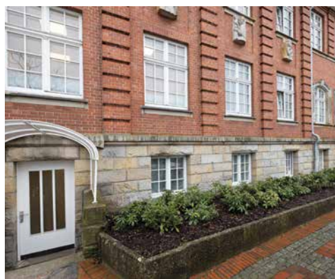
Der Keller des Gebäudes sollte für die Lagerung von Akten und EDV-Servern umfunktioniert werden – vorab war eine umfassende Sanierung erforderlich.
