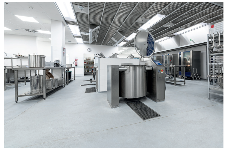
Der Boden in der Küche wird teilweise hohen thermischen Belastungen ausgesetzt.
