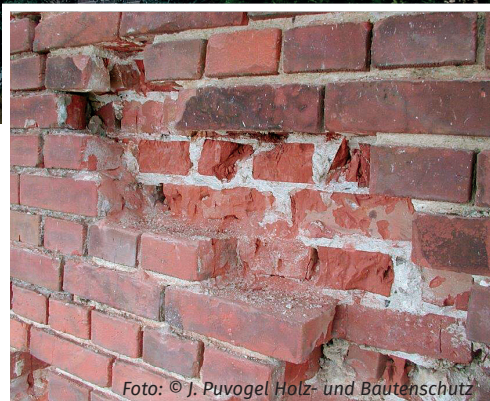
Das Mauerwerk wies starke Schäden auf.
