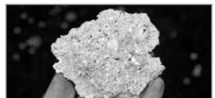
Abb. 5: In der Mitte des abgesprengten Putzstücks ist der „Kalktreiber“ deutlich erkennbar
