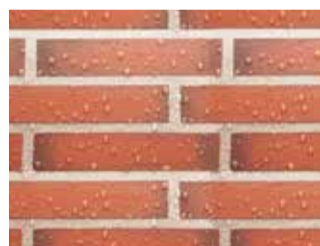
Mur licowy po hydrofobizacji.
