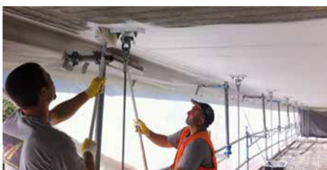
Po aplikacji za pomocą urządzeń natryskowych pracownicy wyrównali „OS Concre-Fill” za pomocą szczotek i miotełek, aby skutecznie pozamykać pory w betonie.
