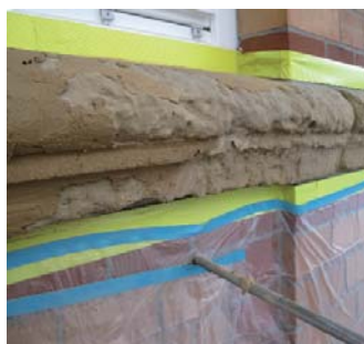
Stark verwitterte Gesimse.
