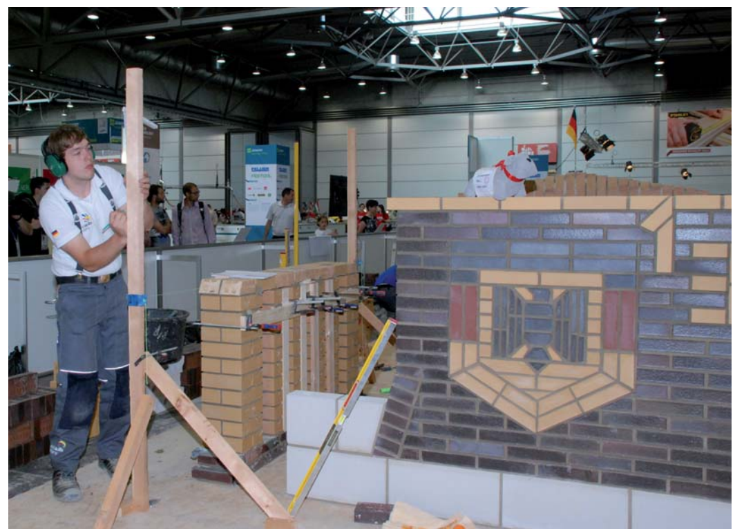
Die Maurer hatten drei Wände zu errichten. Neben dem Leipziger Völkerschlachtdenkmal waren der Bundesadler und das Brandenburger Tor mit Ziegelsteinen in verschiedenen Farben abzubilden. Erforderlich waren viele Schrägschnitte, hinzu kam extremer Zeitdruck.
