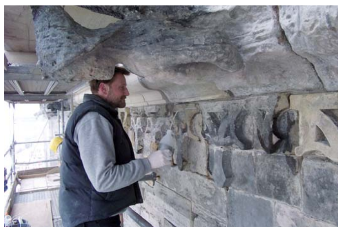
Partielle Festigung sandender Bereiche im Zierfries mit Pipette. Wasserspeier (oberhalb Restaurator) mit extremer Schädigung.
