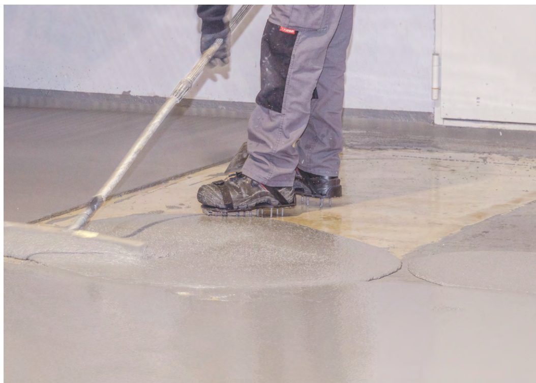
Dzięki zastosowaniu powłoki Crete Flow podłoga jest odporna nawet na duże ciężary i wysokie temperatury
